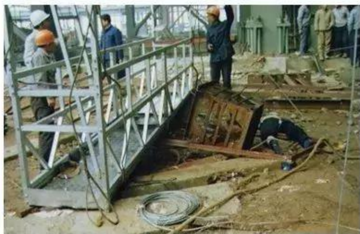
高空作业不系安全带造成坠落
