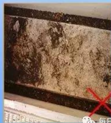
电焊作业焊渣 不及时清理
