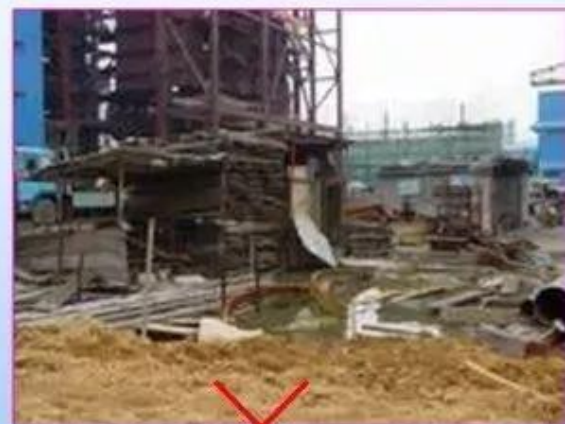
施工现场设备 材料管线堆放 杂乱、无规划
